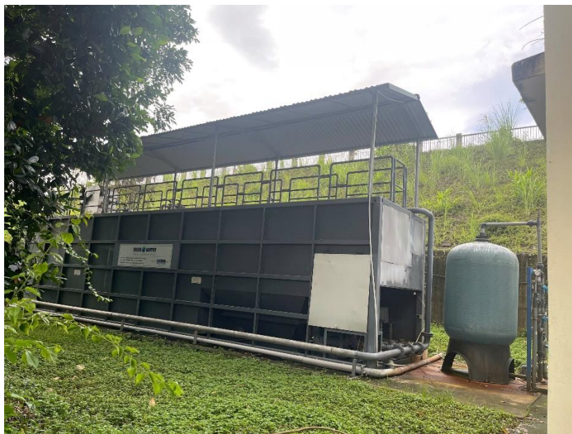
Hình 7: Hệ thống XLNT công suất 200 m 3 /ngày
